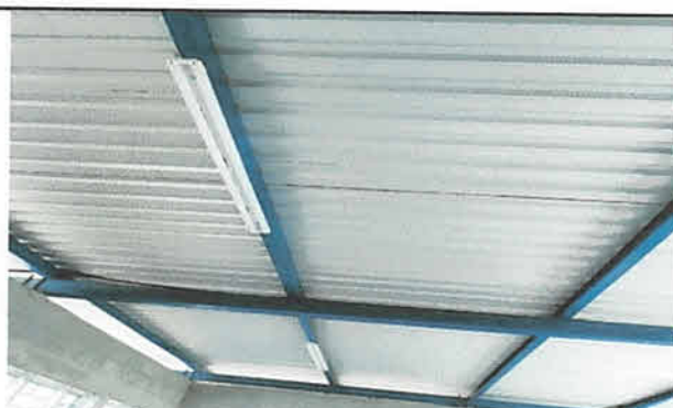
Foto 4: Se cuenta con nuevo sistema de distribución eléctrico desde el tablero de flípones, las 7 lamparas 2 x 40, los dos apagadores y los tres tomacorrientes electricos.
